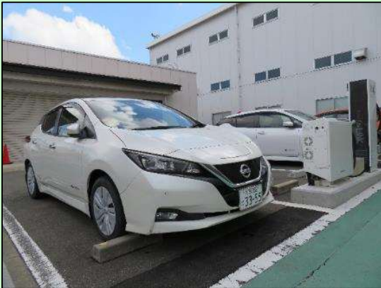
EV車と充電システム
